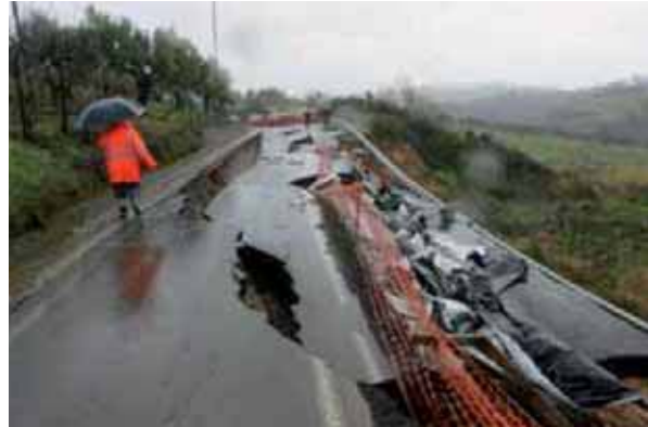
Eventi pluviometrici eccezionali provocano fenomeni di dissesto idrogeologico molto pericolosi come una strada completamente crollata a Roggiano Gravina (CS)
