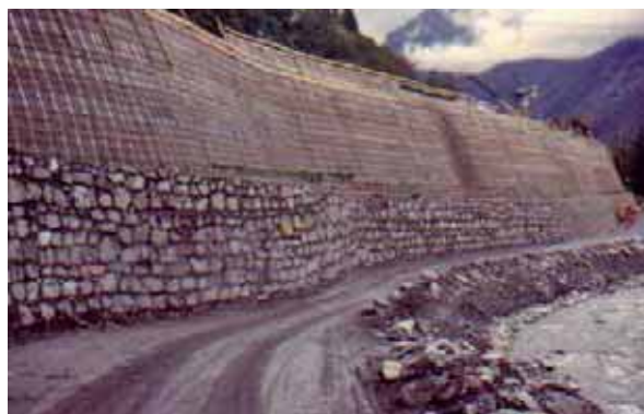
Terra rinforzata verde in fase di costruzione. Svincolo di Morgex , vista dal basso Autostrada Aosta-Monte Bianco Foto G. Sauli
