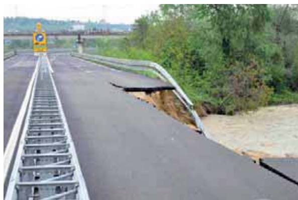
Teramo-mare: tratto franato durante l'alluvione dell'aprile 2010
