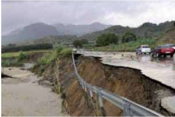
Danni provocati dal maltempo sulla A18 nel tratto Taormina Roccalumera
